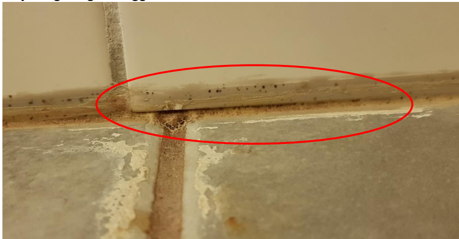
Bild 3. Skada i mjukfog i golv-väggvinkeln.
