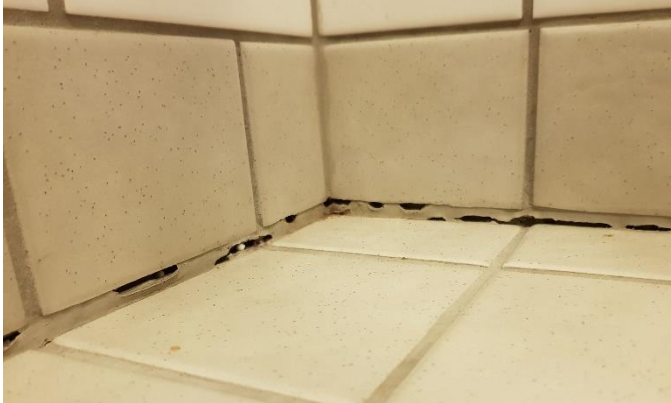
Bild 5. Skador i mjukfog i golv-väggvinkeln.
