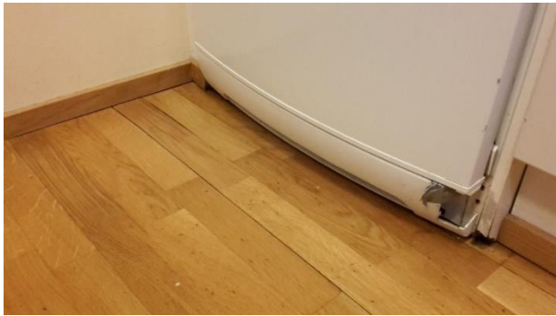
Bild 21. Parkettgolv som utsatts för fukt.
