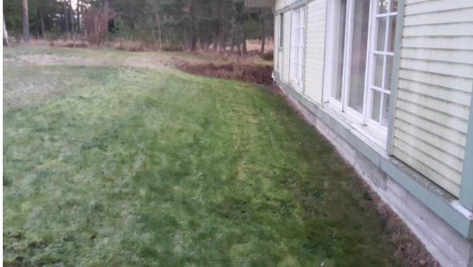
Bild 1. På norra sidan lutar marken mot byggnaden.
