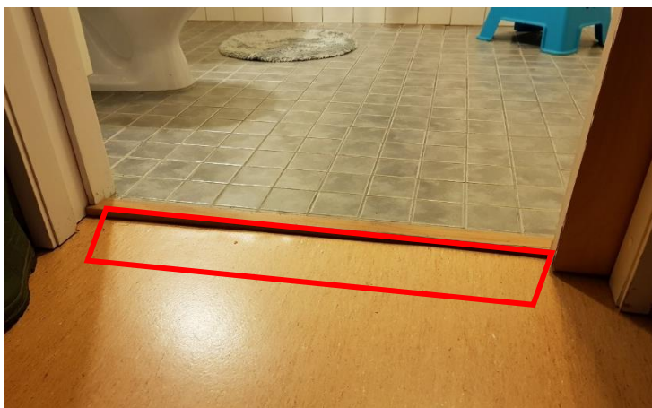
Bild 4. Område där förhöjda fuktvärden noterats samt uppsvälld golvmatta.
