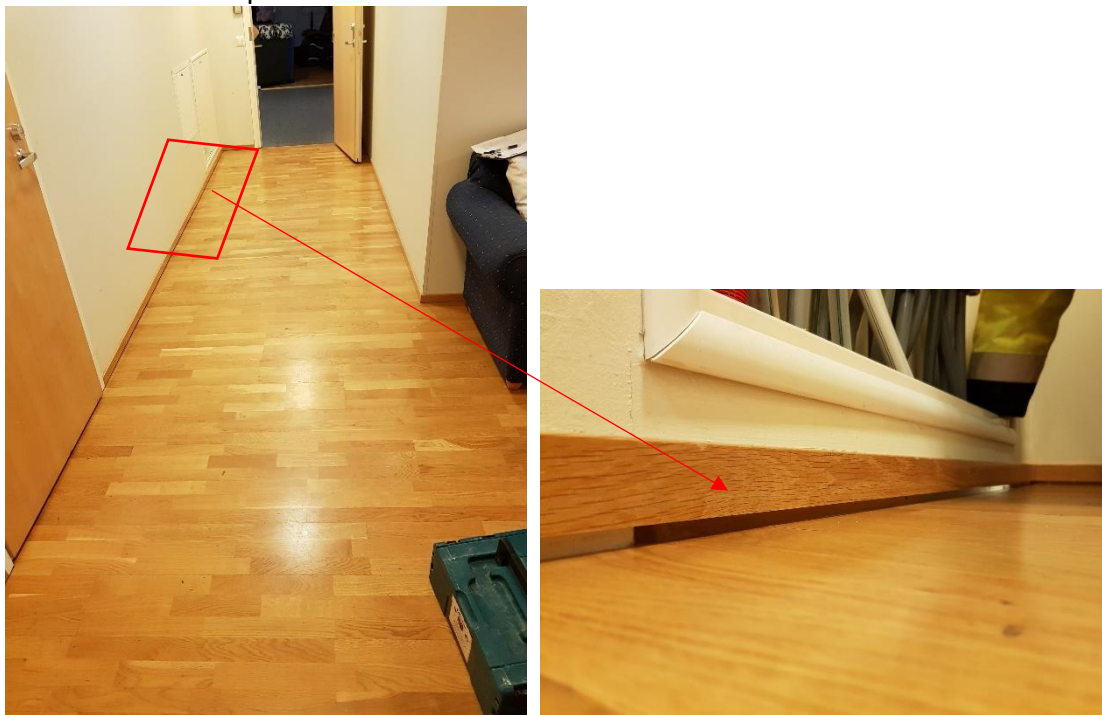
Bild 2. Sättningsskada vid Skadeområde 1.
