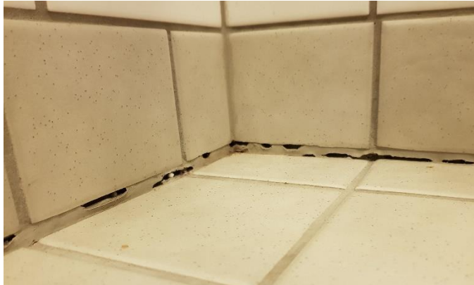
Bild 5. Skador i mjukfog i golv-väggvinkeln.
