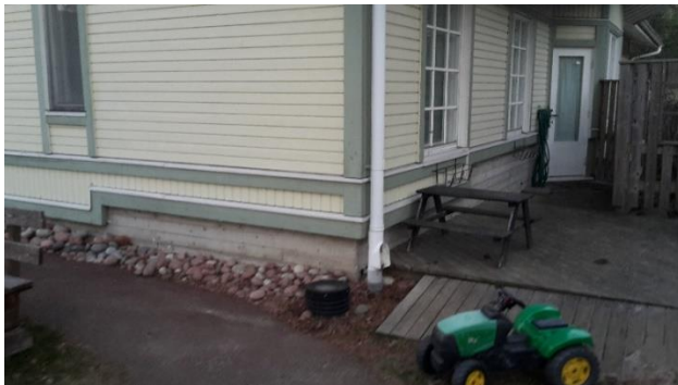
Bild 3. Fasadpanelen är monterad i olika höjd på sockeln.
