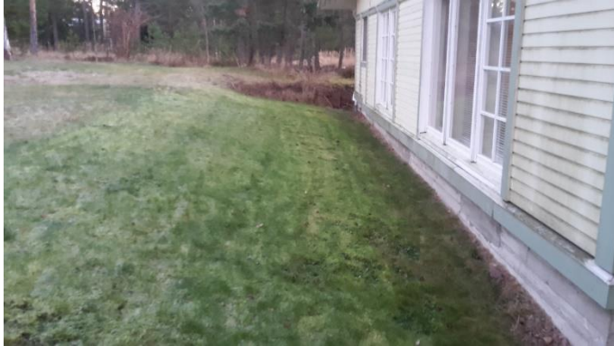
Bild 1. På norra sidan lutar marken mot byggnaden.
