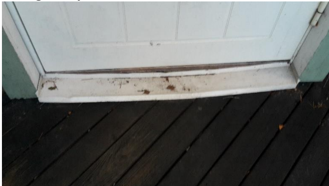
Bild 8. Söndertrampat plåtbleck under dörr.
