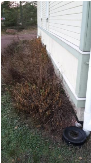
Bild 4. Växtlighet mot fasaden.
