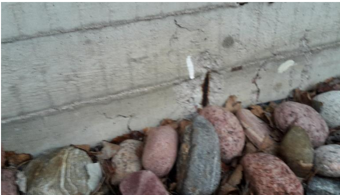
Bild 5. Armeringen har sprängt lös delar av betongen.
