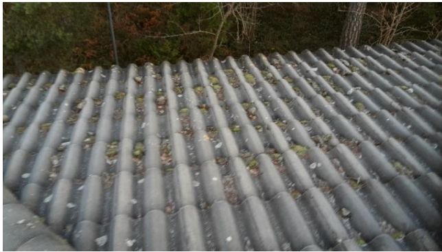
Bild 11. Mossa finns i varierande mängd på taket.
