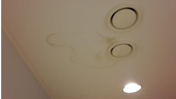
Bild 22. Vattenskada i taket.
